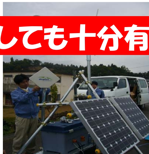
移動型+Webカメラ 於河川堤防
